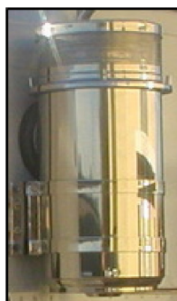
Le boîtier d'origine (FEO) est à l'extérieur et exposé à la pluie.
